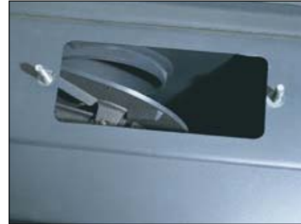
Il registro aria in ghisa permette di agevolare l'accensione della caldaia.
